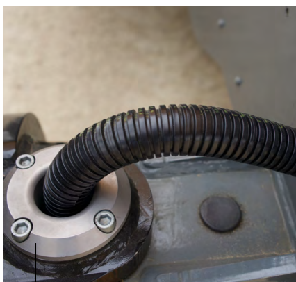
Excellente protection des câbles électriques les plus exposés
